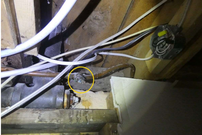
Sous-sol (robinet extérieur)
