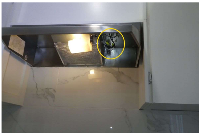
Hotte de cuisinière (RDC)
