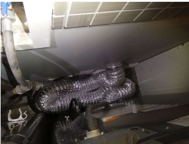
Derrière la sécheuse
