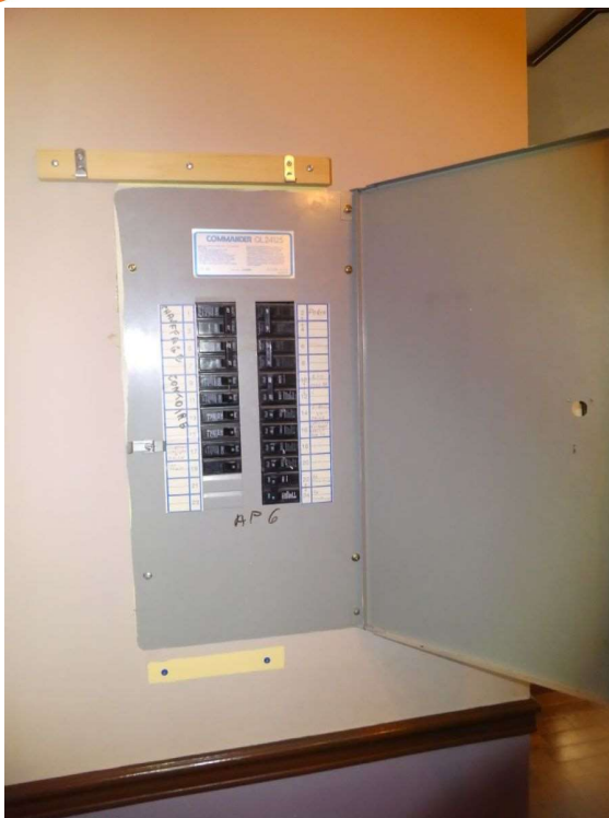
Panneau électrique Commander
